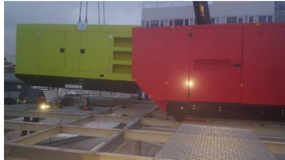
Instalación en azotea de los grupos electrógenos
