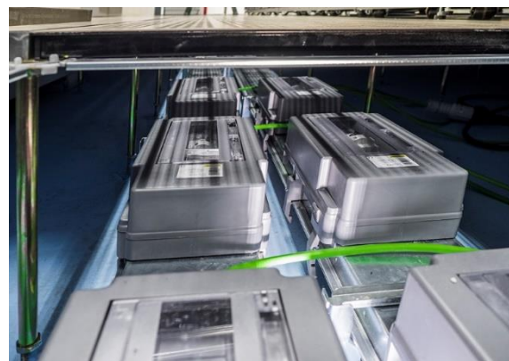
Cajas de distribución eléctrica instaladas en blindobarras
