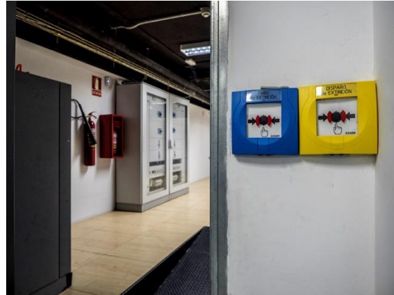
Cuadros eléctricos de distribución
